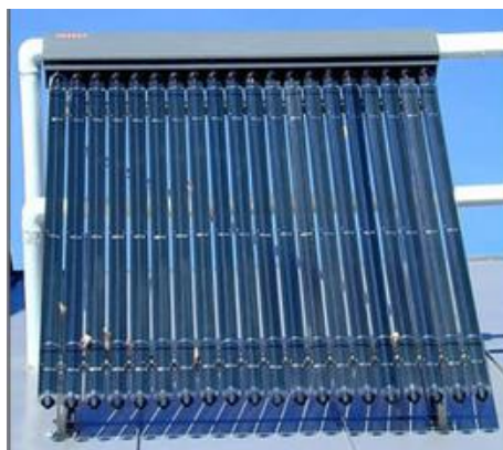
Ilustración 5. Colectores de tubos de vacío
